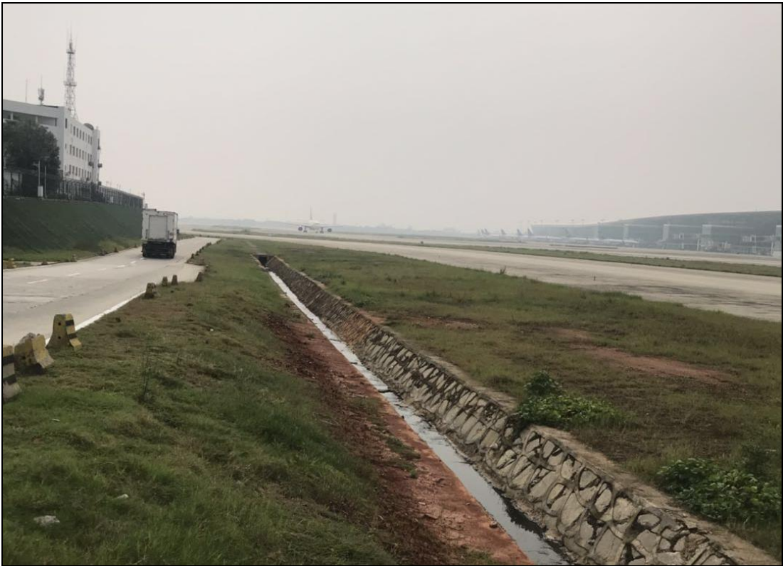
图 5.3-1 既有 B1 排水沟现状
